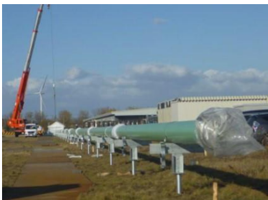
超電導直流送電管(出典:石狩市)
