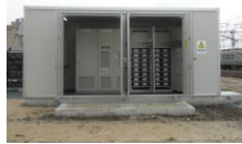
福島駅構内蓄電池建屋 (出典:GSユアサ社)
