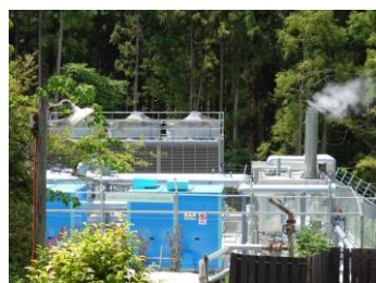
日帰り温泉施設「五湯苑」の地熱発電所（大分県）出典：MAG10C
