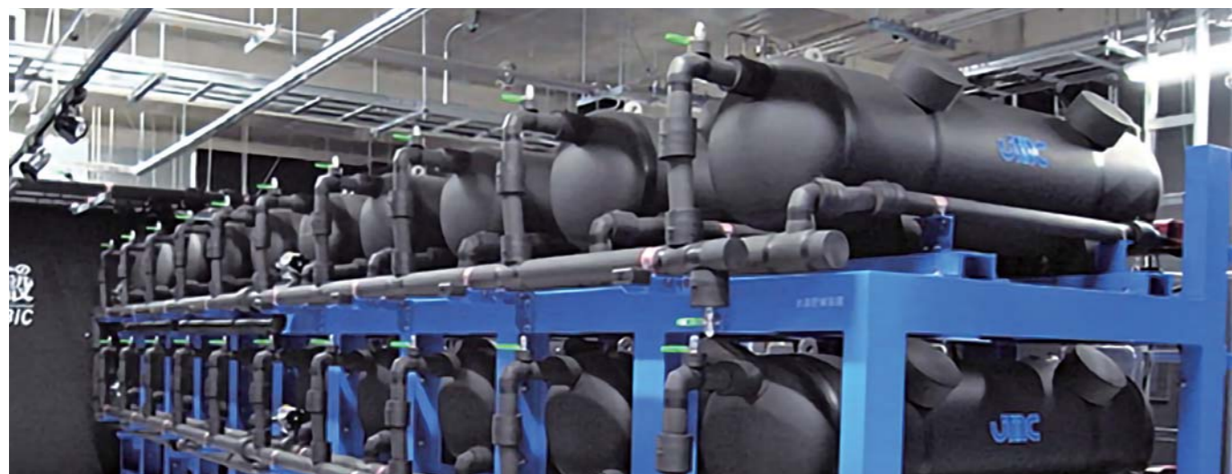
建設会社の新社屋に採用された水素吸蔵合金のタンク
