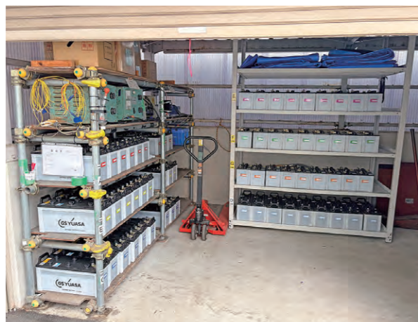
倉庫に保管された仮説電池
