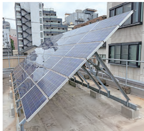
屋上に設置された太陽光パネル
